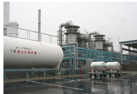
a) 液化水素貯蔵タンク a) Liquefied Hydrogen Storage Tank
