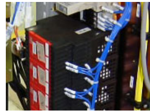
AS-Interface Safety at Work セーフティモニタ (制御ラック内)
