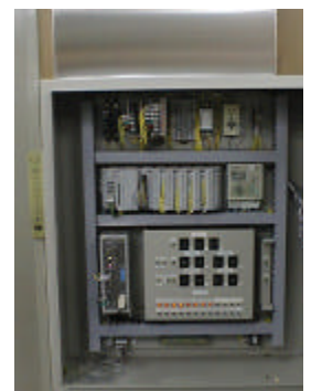
メイン制御盤
