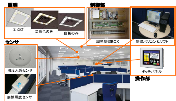
図5 オフィスの調光制御機器 Fig.5 Dimming control equipment in office
