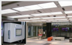
【ソニービル】LED照明制御システム ※LED照明は、他社製品をご採用いただいています。
