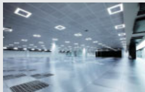
【TIS株式会社】「心斎橋gDC」サーバールーム
